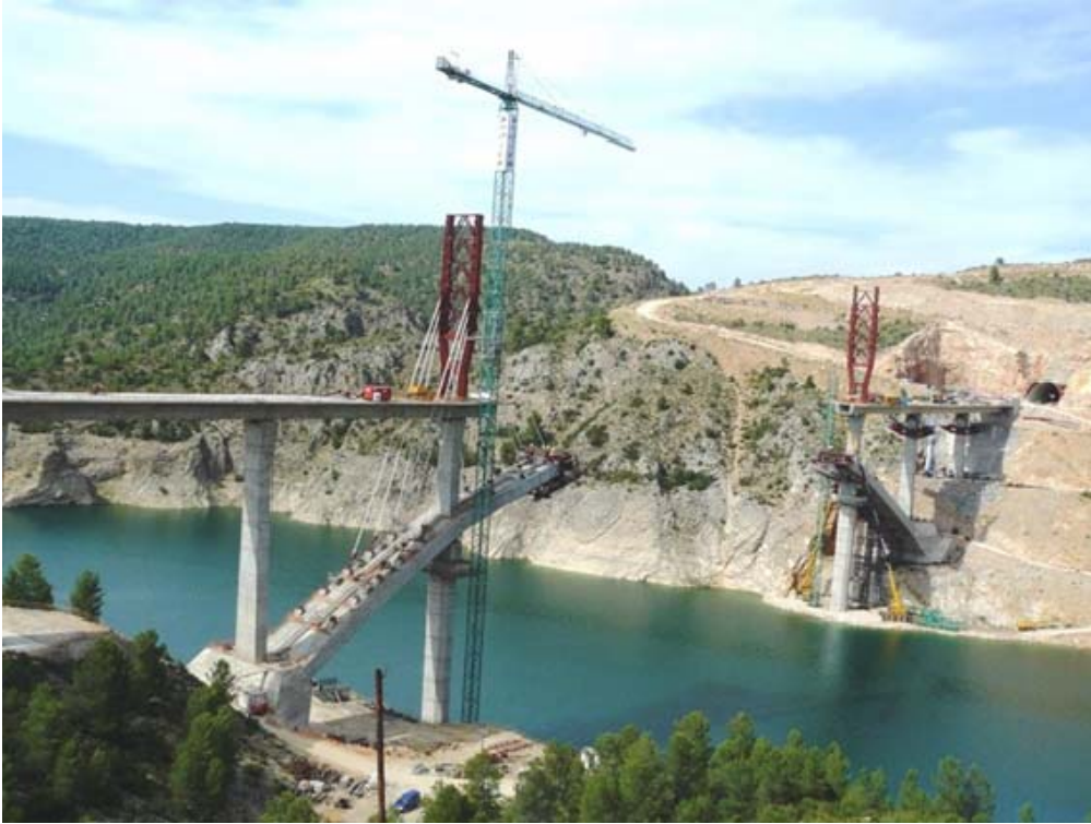
Fig 1. Vista de las obras del Viaducto sobre el Embalse de Contreras desde el lado Cuenca
